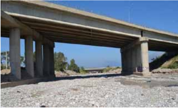
Αντιπλημμυρικά έργα στον ποταμό Χάραδρο αποκατάσταση και συμπλήρωση αναβαθμού Βελβιτσίου απομάκρυνση φερτών στο πεδινό τμήμα του
