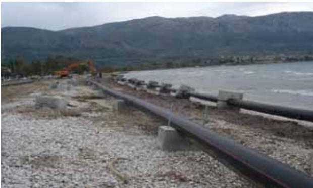
Αποχέτευση ακαθάρτων (Εσωτερικά Δίκτυα Οικισμού Μυρσίνης και Υποθαλάσσιος αγωγός κοινού Ανδραβίδας Λεχαινών Τραγανού
