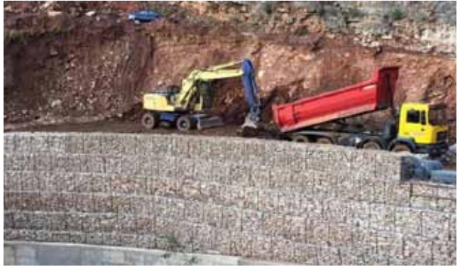
Αποκαταστάσεις απο την θεομηνία της 30ης Νοεμβρίου 1ης και 2ας Δεκεμβρίου 2017 στην Π.Ε. Αιτωλοακαρνανίας της ΕΟ 17
