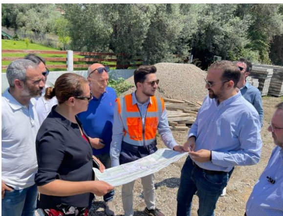
Αρχαία Πίσα-ΠΕ Ηλείας: Εργασίες αποκατάστασης της εκτεταμένης κατολίθησης που προκλήθηκε από καταστροφικές πυρκαγιές.
