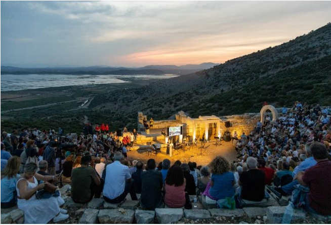
Τελετή εγκαινίων του έργου «Στερέωση, Αποκατάσταση και Ανάδειξη αρχαίου θεάτρου Πλευρώνας» παρουσία της Υπουργού Πολιτισμού Δρ. Λίνα Μενδώνη.
