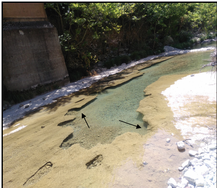
Εικ. 5: Υποσκαφή (προ των εργασιών). Άποψη από το επίπεδο της κοίτης.
