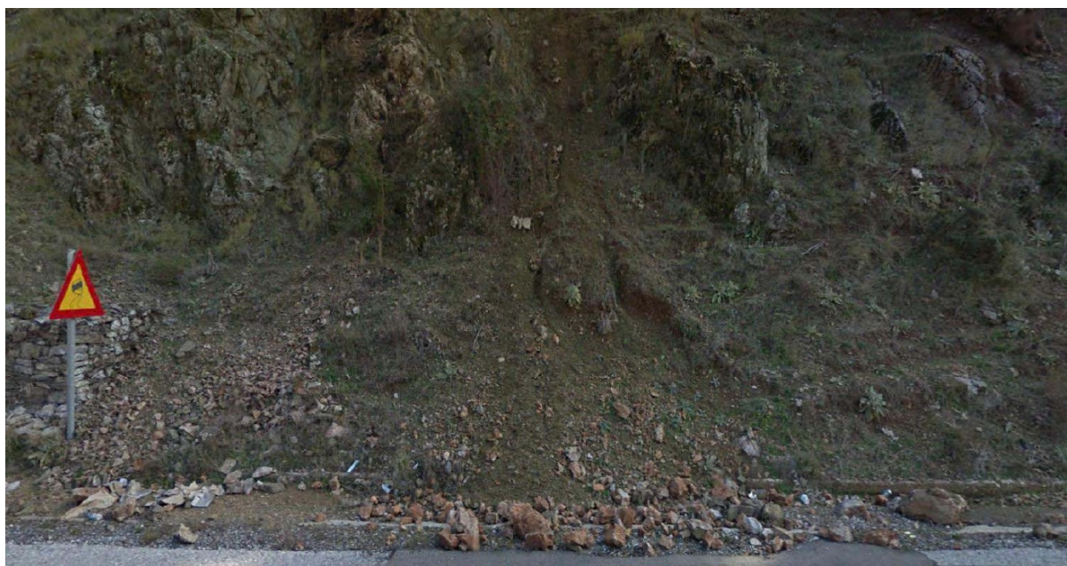
Φωτ 3: Θέση Λαμπεία_2 στην ΧΘ : 78.000 :Κατακερματισμένο βραχώδες πρανές σε συνδυασμό με αποσθρωμένο μανδύα
