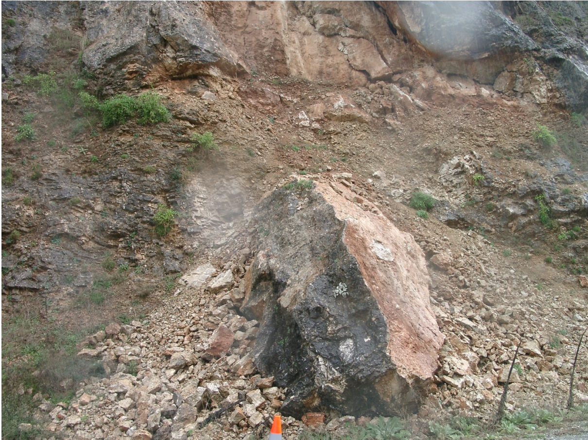
ΦΩΤ 9: Ασβεστολιθικός όγκος που έχει αποκοπεί και έχει καταλήξει στην άκρη του οδοστρώματος
