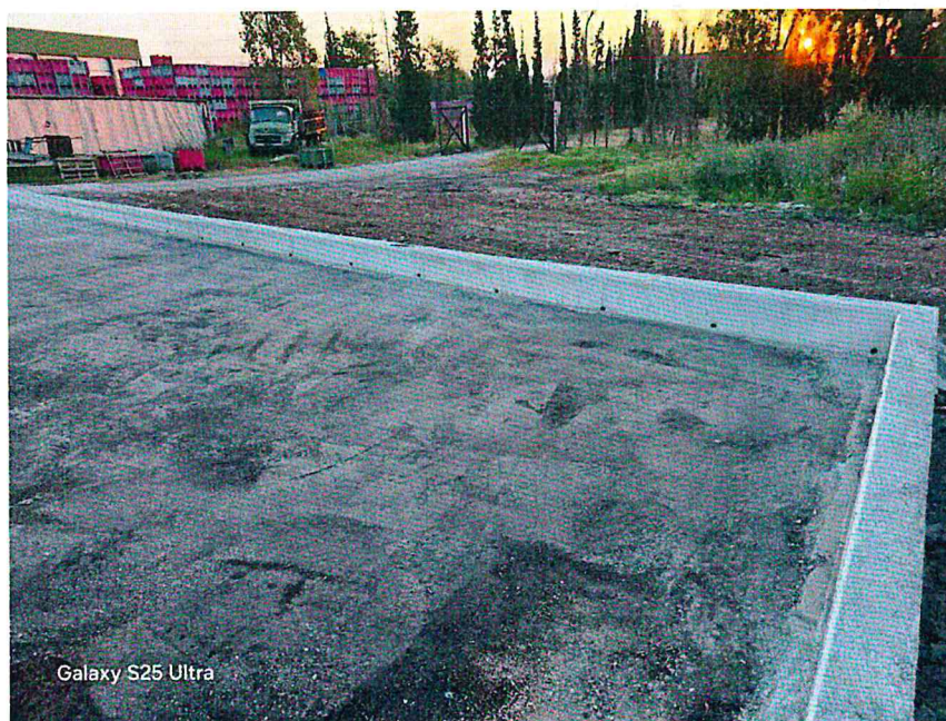
Φωτό 4 : Υπαίθρια στεγανοποιημένη επιφάνεια προσωρινής απόθεσης ξυλώδους μίσχου/"τσίγγανων" με σύστημα συλλογής στραγγισμάτων και αποθήκευση σε υπόγεια στεγανή δεξαμενή.
