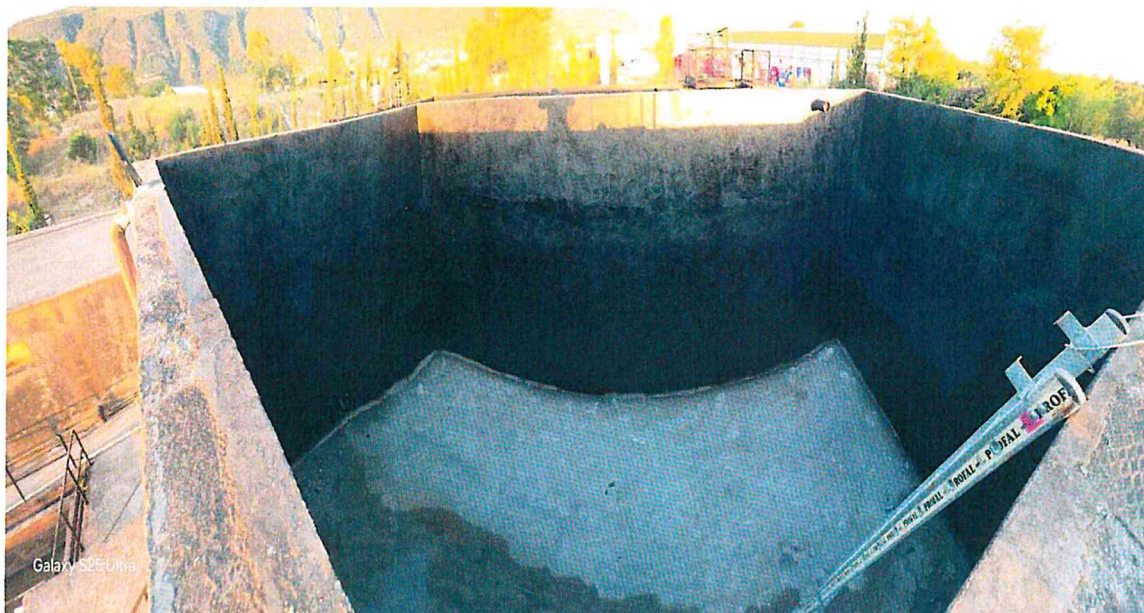
Φωτό 5 : Υπέργεια δεξαμενή συγκέντρωσης-αποθήκευσης λυμάτων/υγρών αποβλήτων.
